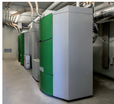
Innenansicht der Heizzentrale
